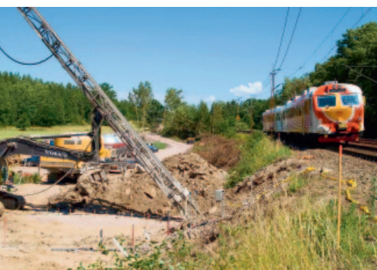
Рис. 1. Подготовка к обустройству наклонной сваи на одной из линий железных дорог Швеции (источник: Innotrack)
