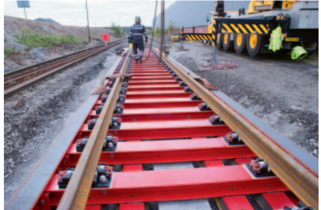
Рис. 3. Обустройство опытного участка путевой структуры компании Cogus на одной из линий железных дорог Великобритании (источник: Innotrack)
