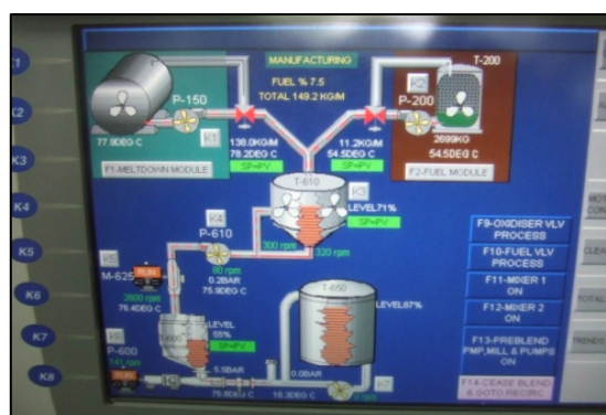
Рис. 3. Вид монитора центрального пункта контроля
