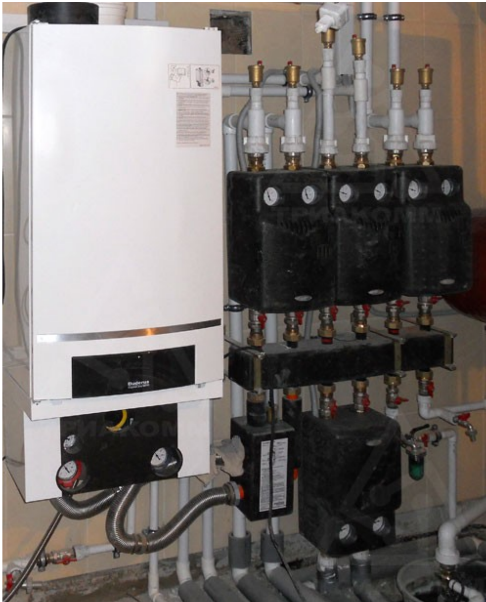
На фото — конденсационный настенный котел Buderus
