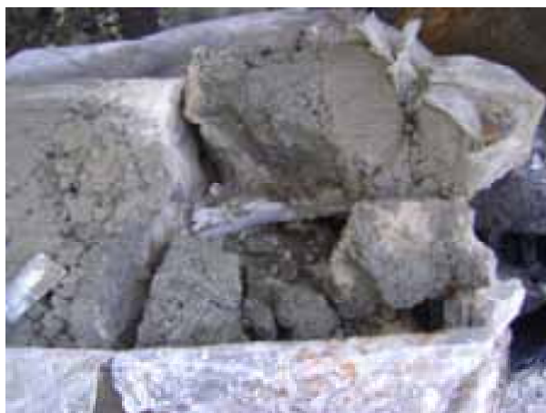
Рис. 3 Общий вид разрушенного бетона внутри трубы
