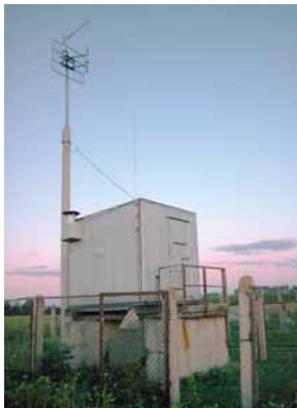
Контролируемый пункт магистрального газопровода
