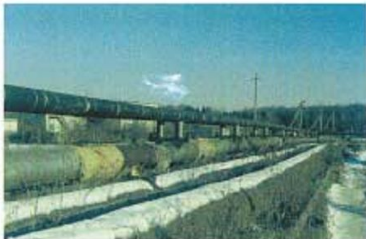
Фото 8. Трубопровод в изоляции скорлупами из ППУ.
