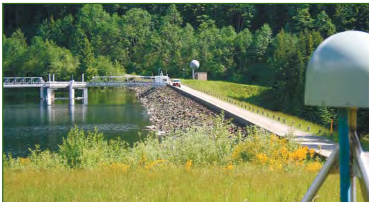
Рис. 2 Мониторинг деформаций и смещений гидротехнического сооружения ( www.trimble.com )
