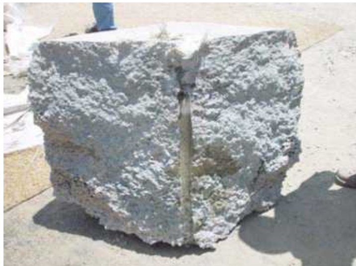
Рисунок 3: Фрагмент от уничтожения PCF бетона
