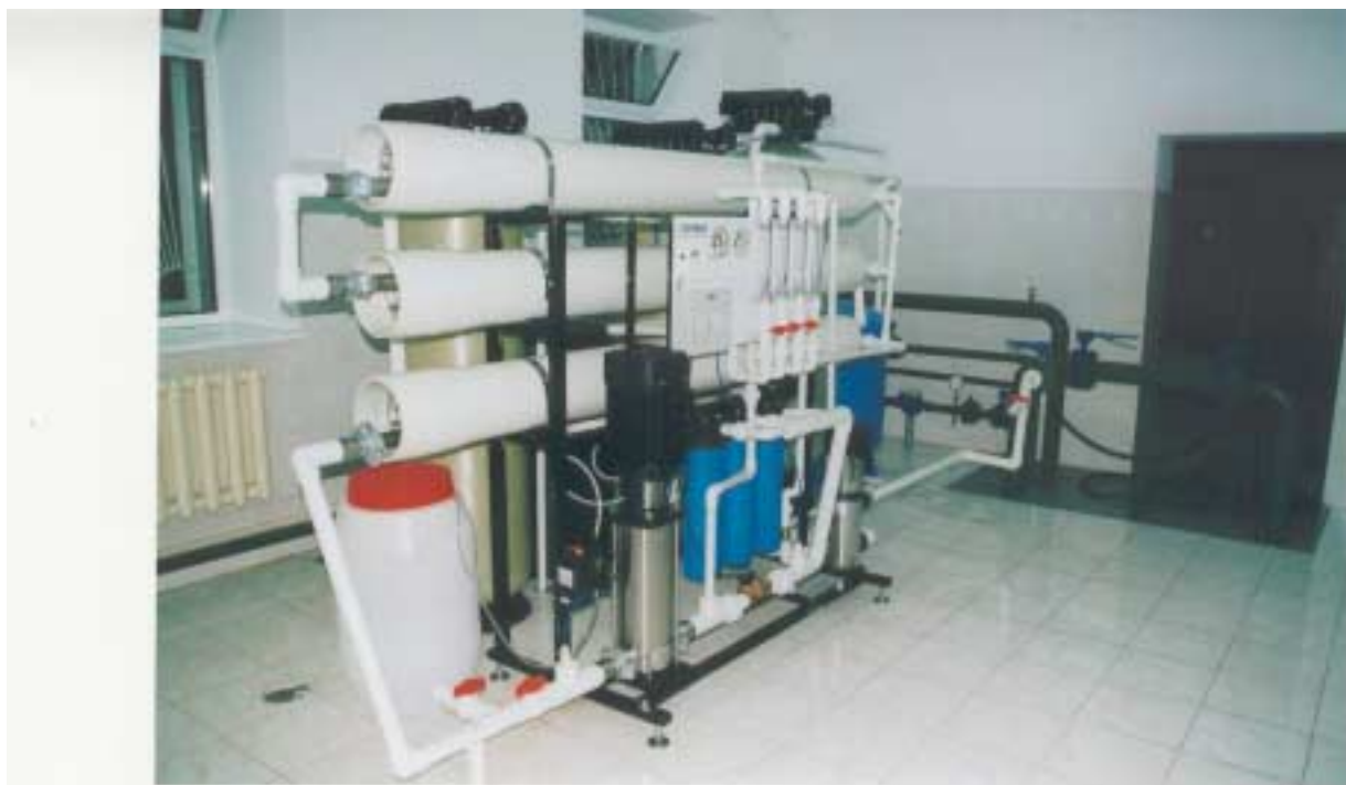
Обратноосмотическая установка пункта доочистки воды 5 м 3 /ч. г. Киев
