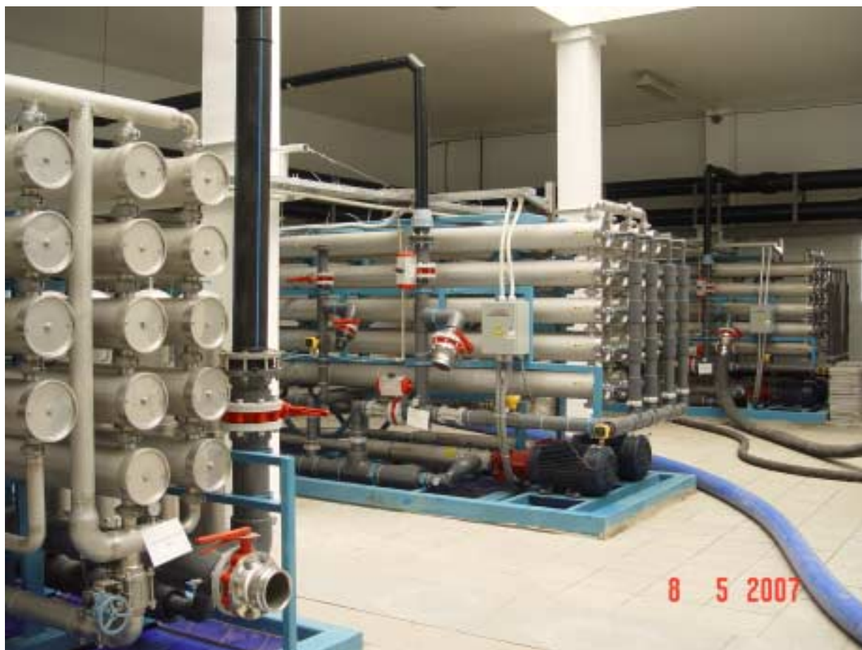
Обратноосмотические установки завода по производству питьевой воды 500 м 3 /ч ООО «Аквасервис». г. Алчевск.
