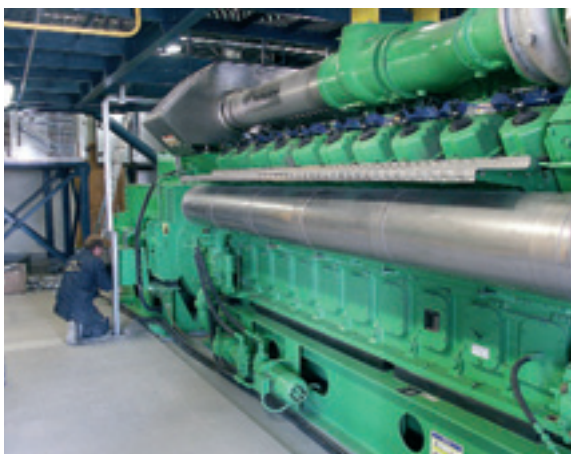
Фото 1. Газопоршневой агрегат JMS 620 GS-N.LC
