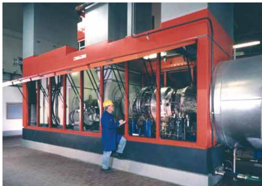
Рис. 2. Газотурбинная установка Solar C50 электрической мощностью 4,6 МВт и тепловой 11,05 МВт, общий КПД равен 80%
