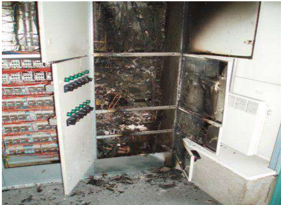
Рисунок 4: Монтажная коробка разрушена из-за ослабленных соединений или изношенного компонента
