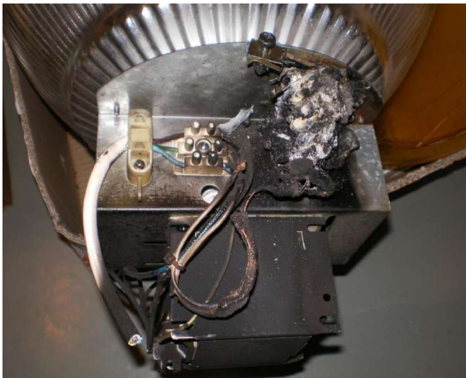
Рисунок 5: Прожектор поврежден из-за дефекта в компенсационном конденсаторе
