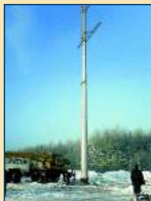
Опоры воздушных линий электропередачи ВЛ 6-10, 10-35, 110 кВ
