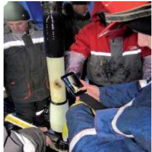
Рис. 6. Дефект изоляции концевой муфты
