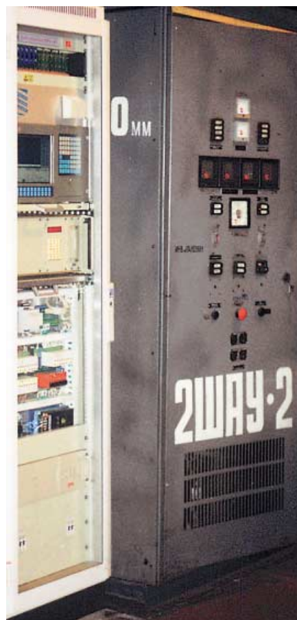
Рис. 5. Шкаф управляющей ЭВМ
