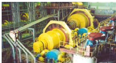
Рис.1. Установка с двумя рудоразмельными мельницами на ГОК “Олимпиадинский”
