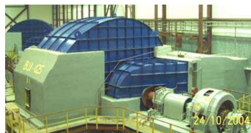
Рис.2. Вентиляторы главного проветривания ВЦД-42,5 рудника “Северный-Глубокий”
