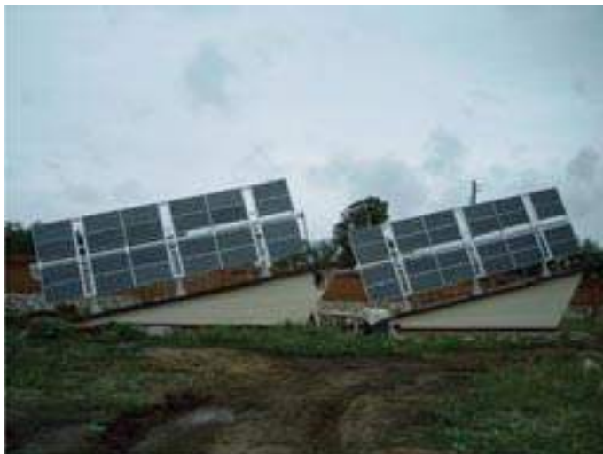
Рис.1 Солнечная электростанция 4 кВт
