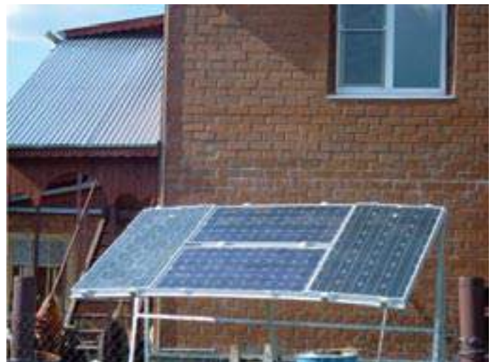
Рис.2 Солнечная электростанция 0,5 кВт
