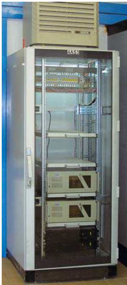
Рис. 4. Шкаф Rittal с промышленными компьютерами
