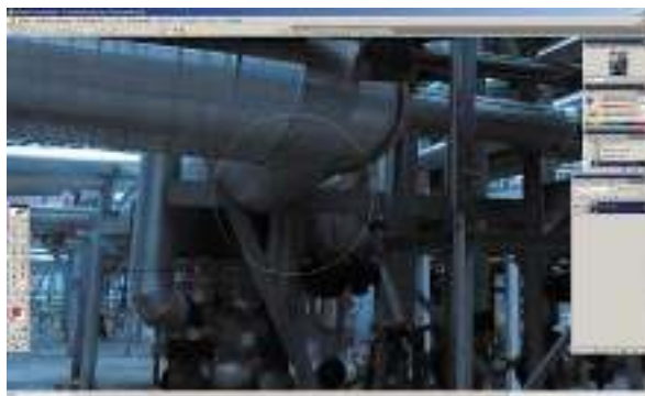
Рис. 4. Фотография пересечения (коллизия) утеплителя с несущей конструкцией
