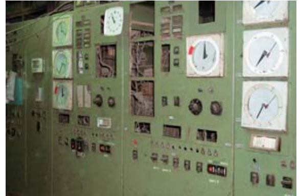
Рис. 9. Щит управления котлом до реконструкции
