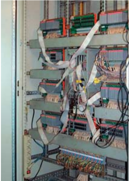
Рис. 7. Оборудование в шкафу управления
