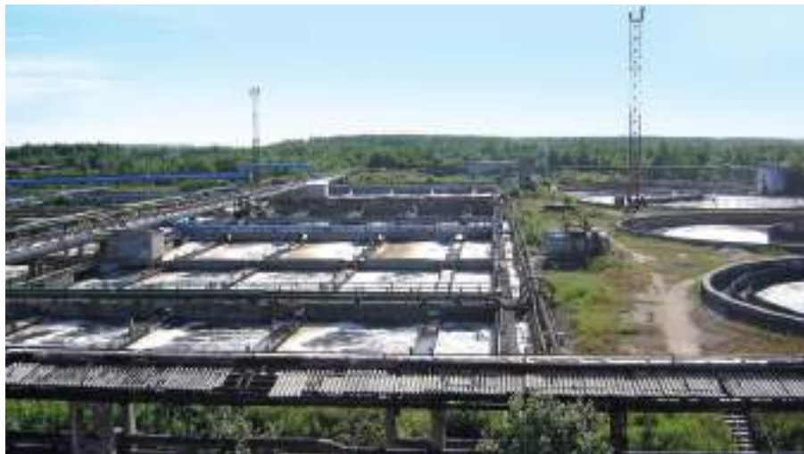
Рис. 1. Общий вид территории станции биологической очистки
