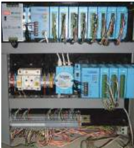
Рис. 6. Шкаф автоматизации сбора данных с удалённых локальных объектов на базе контроллера ADAM-5000/TCP
