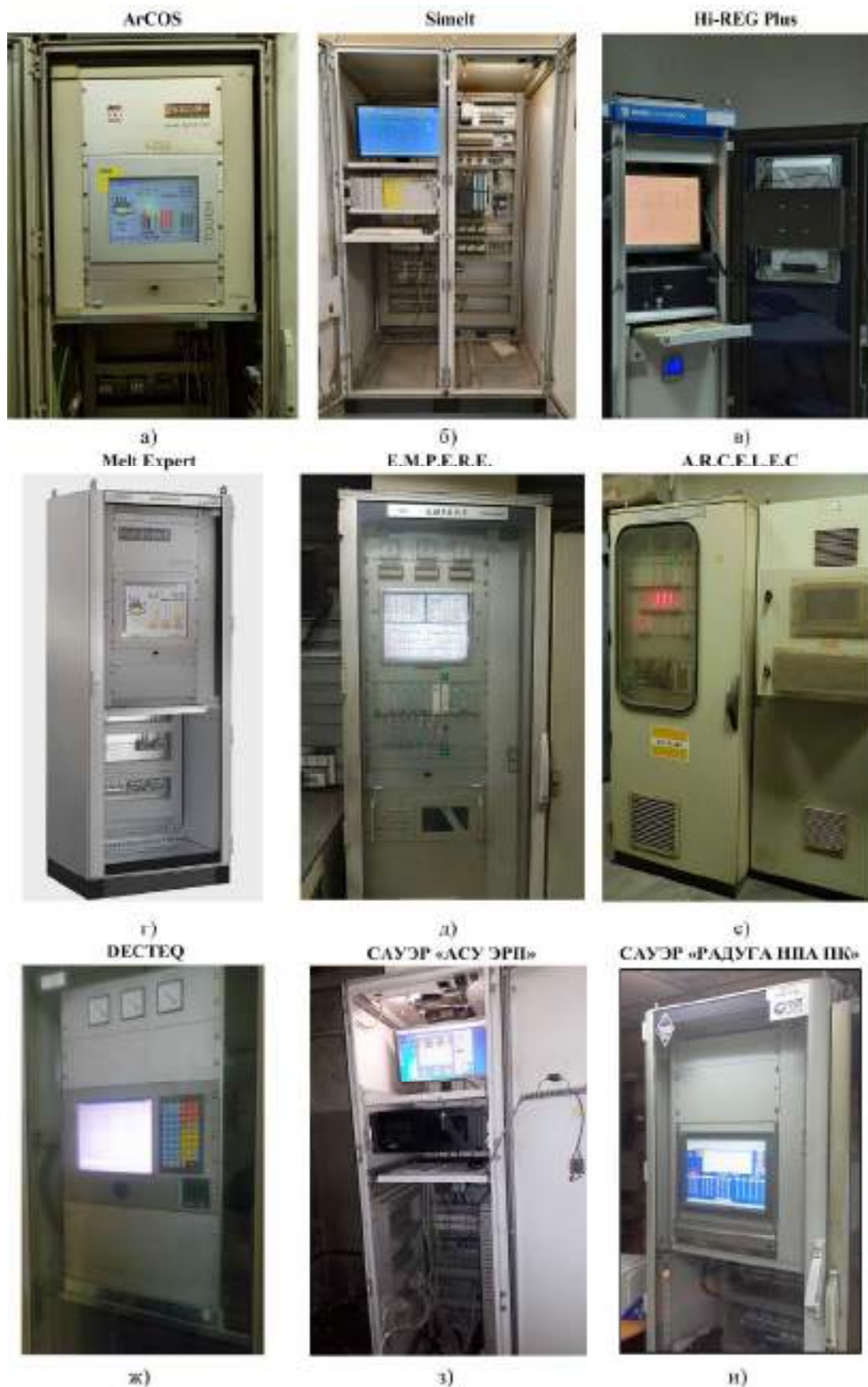
Рис. 1. Внешний вид основных шкафов с оборудованием систем автоматического управления электрическими режимами и перемещением электродов ДСП и УКП зарубежного и отечественного производства
