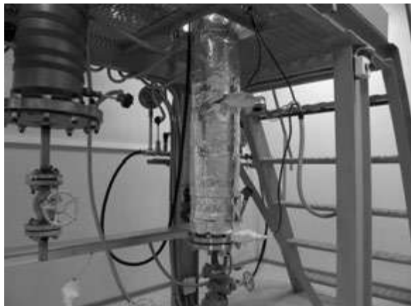
Рис. 6. Колонна термоокисления К-1
