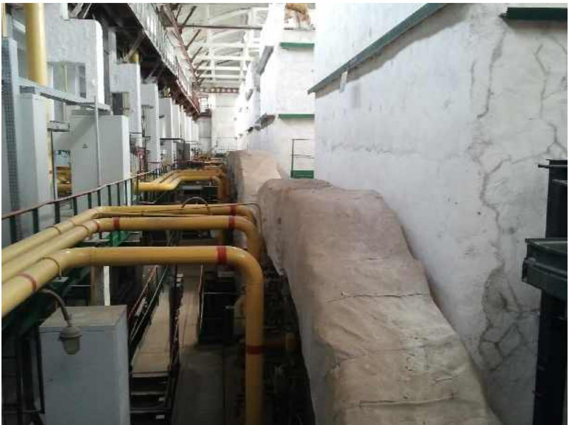
Рисунок 1 – Котлы КВГМ-100 на котельной «Южная» (г. Витебск)
