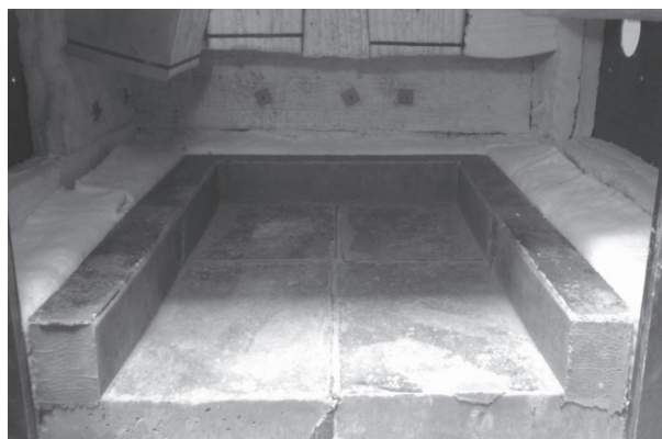
Рис. 8. Бордюры рабочего слоя печи
