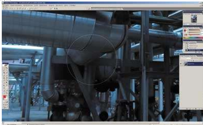
Рис. 4. Фотография пересечения (коллизия) утеплителя с несущей конструкцией
